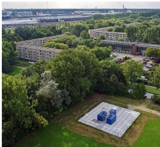
Power2Gas-installatie in Rozenburg met de waterstofinstallatie (blauwe containers) en het appartementencomplex (links) dat met waterstof wordt verwarmd.
