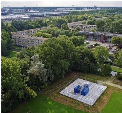
Power2Gas-installatie in Rozenburg met de waterstofinstallatie (blauwe containers) en het appartementencomplex (links) dat met waterstof wordt verwarmd.
