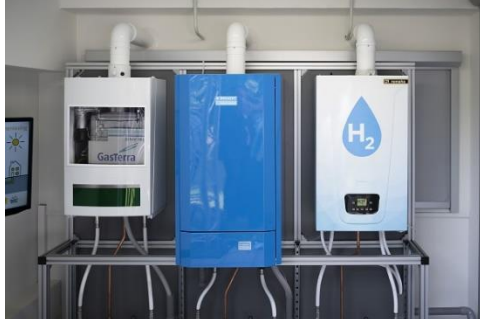
De drie HR-ketels op 100% waterstof van: Gasterra, Bekaert Heating en Remeha.
